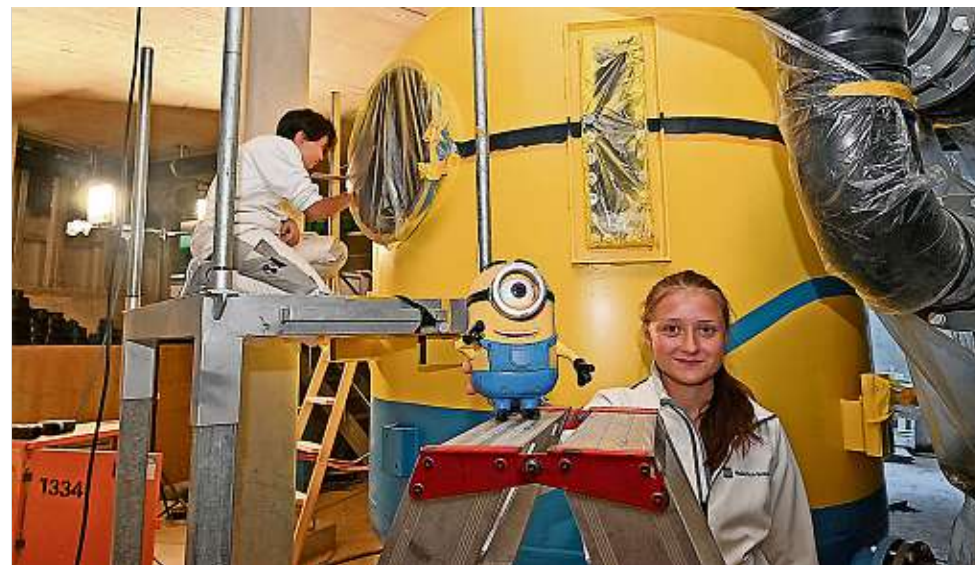
Azubis des ersten Lehrjahrs der Kamenzer Malerfirma „Heinrich Schmid“, hier Jolina Franz (links) und Sina Berger, geben dem Mehrschichtfilter der Badewasseraufbereitung im Technikraum der neuen Schwimmhalle ein neues Aussehen – die Bauform war praktisch eine Steilvorlage.
