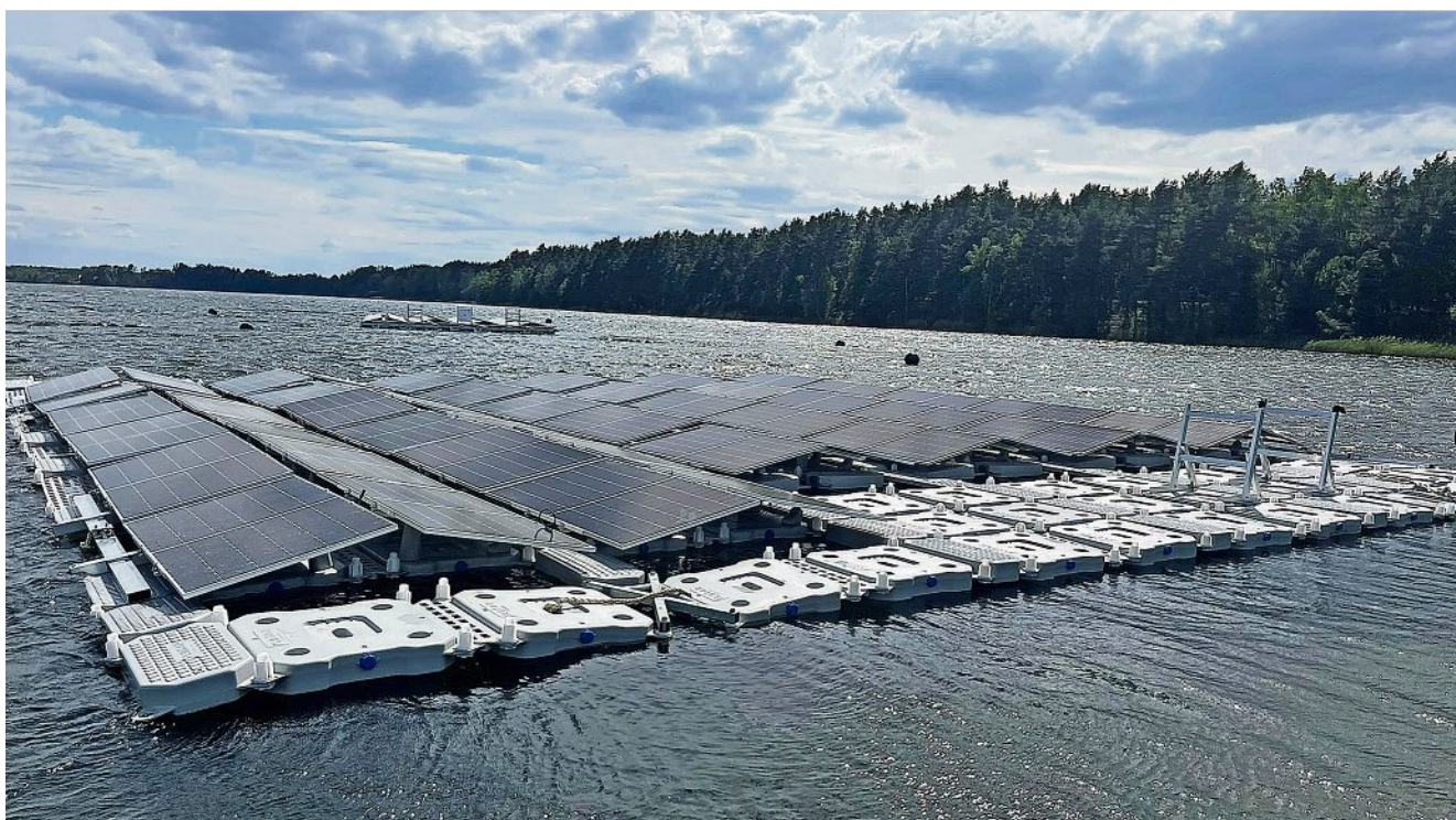
Diese Anlage schwimmt auf dem Mortkaer See. Eine weitere gleicher Bauart steht an Land. Die Frage der Forscher: Welche arbeitet effizienter?
