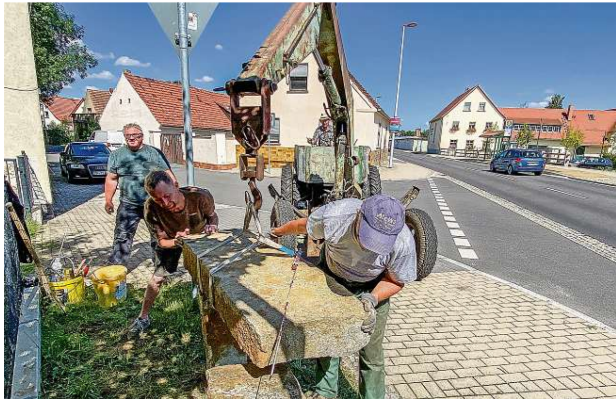
Einen Vormittag hatten Eugen Diesterheft (vorn), der zu diesem Zeitpunkt noch Ortsvorsteher war, und drei Helfer zu tun, um die Milchrampe an der der Ortsmitte von Dörghenhausen (rechts hinten) gegenüberliegenden Straßenseite zu errichten. Foto: Ralf Grunert
