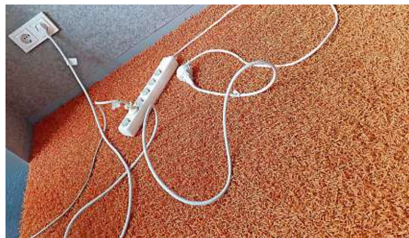
Kabel sollten sich wild auf dem Fußboden schlängeln; so werden sie zur gefährlichen Stolperfalle! Foto: Jens Fritzsche
