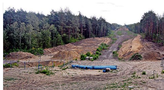
Das Bild entstand von der einstigen B-97-Brücke. Zu sehen ist die Trasse der künftigen Südanbindung für den Industriepark Schwarze Pumpe. Foto: Mirko Kolodziej
