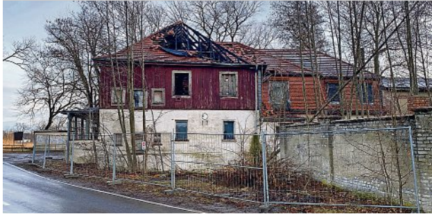
Das Feuer hat das Dach des einstigen Gaststättenteils der Hüttenschänke zerstört. Seither wird das Gebäude durch einen umlaufenden Zaun gesichert. Foto: Ralf Grunert
