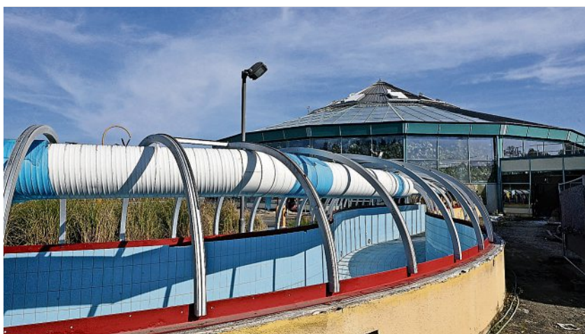
Der Strömungskanal ist vorübergehend ohne Dach. Hier musste Korrosion entfernt und neuer Rostschutz aufgebracht werden.
