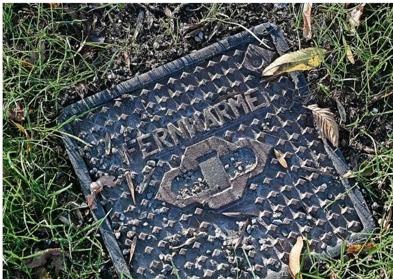
Abdeckung der Versorgungsbetriebe Hoyerswerda über einer Fernwärmeleitung in der Fischerstraße/Straße am Lessinghaus, Ecke Burgplatz. Foto: Uwe Schulz
